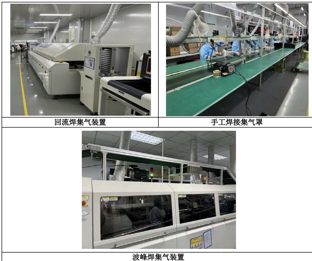
图4-1 国内同行业废气收集措施实景图
